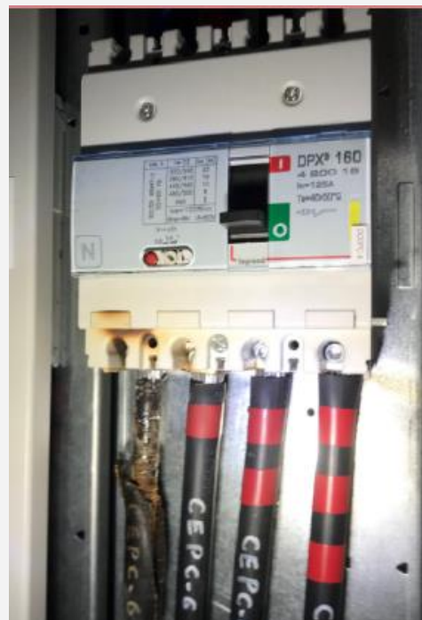
Conséquence du raccordement de câbles aluminium sur des bornes prévues exclusivement pour du cuivre
